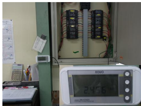
各設備の電力量測定の実施
